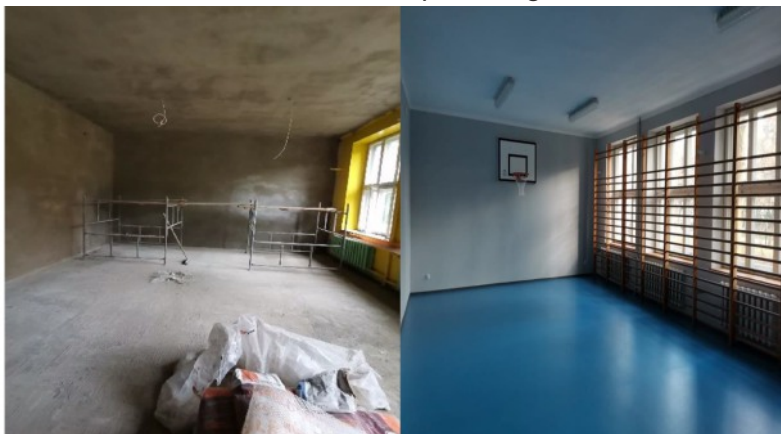
Na zdjęciach powyżej salka gimnastyczna w Szkole Podstawowej w Pleckiej Dąbrowie w czasie remontu i po remoncie
